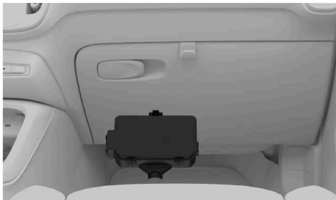
Ubicación de la caja de fusibles
