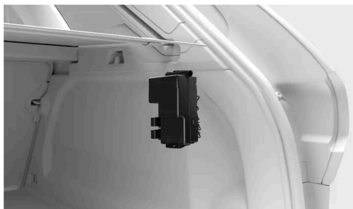
Emplacement du boîtier à fusibles
