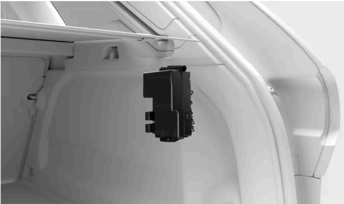
Lage des Sicherungskastens
