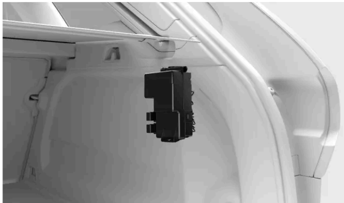
Lage des Sicherungskastens
