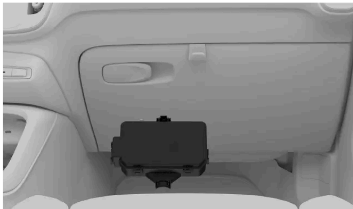
Placering af sikringskab
