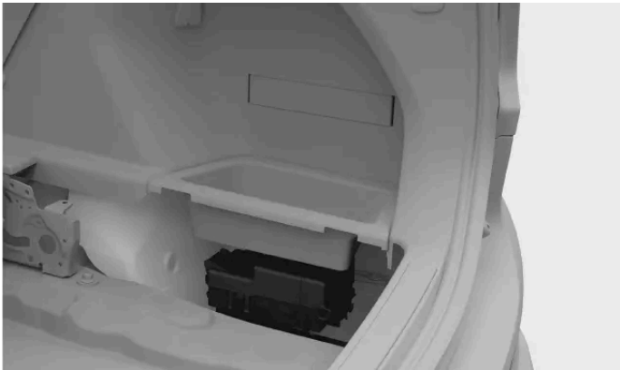
Placering af sikringsskab
