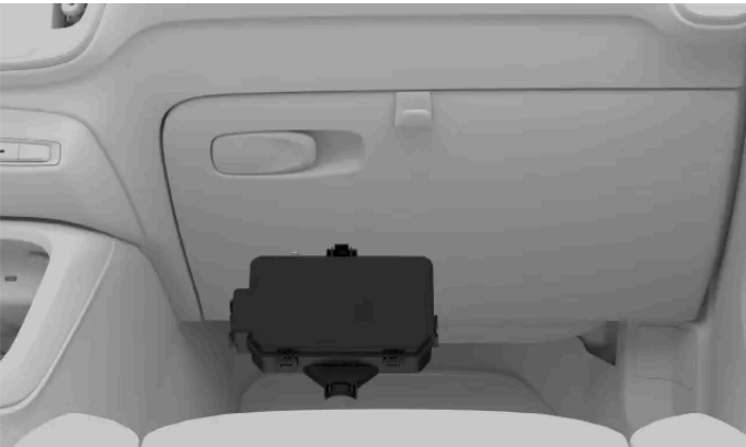
Placering af sikringsskab
