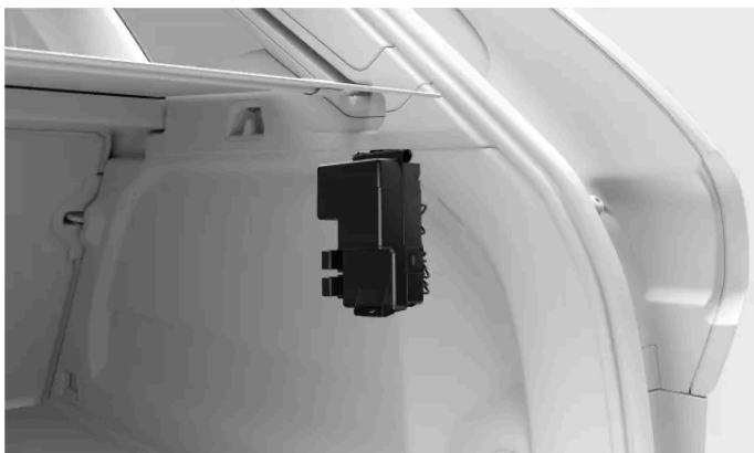
Placering af sikringsskab
