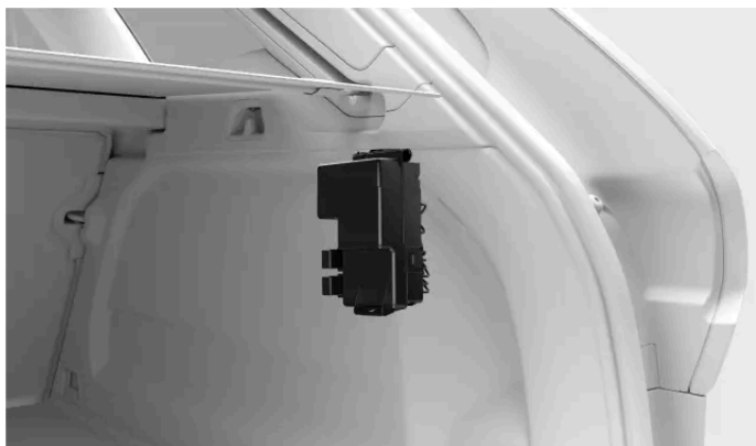
Placering af sikringsskab
