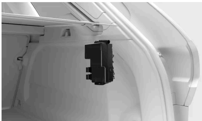
Ubicación de la caja de fusibles
