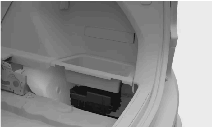
Emplacement de la boîte à fusibles
