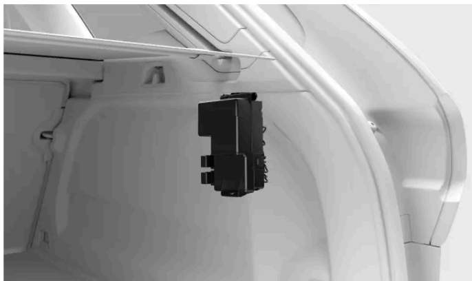
Emplacement de la boîte à fusibles
