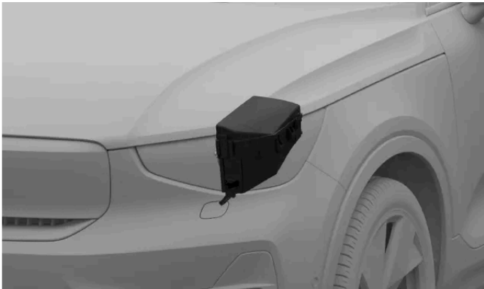
Posizione del portafusibili
