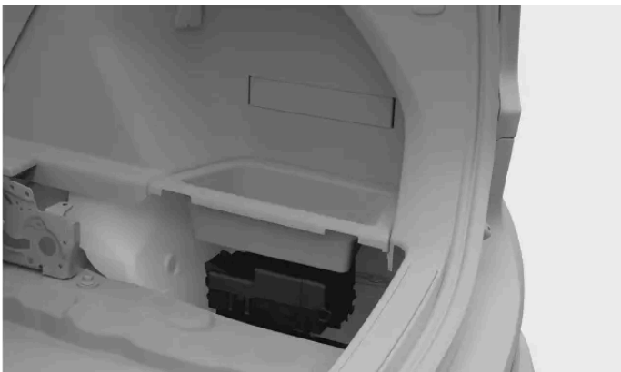
Posizione del portafusibili
