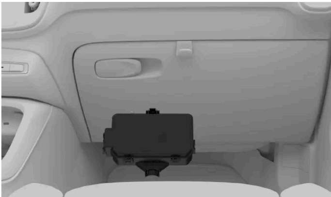
Położenie skrzynki bezpieczników
