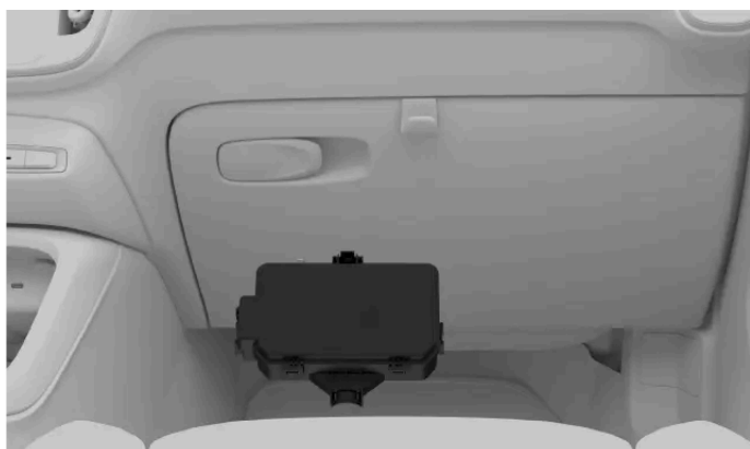
Położenie skrzynki bezpieczników
